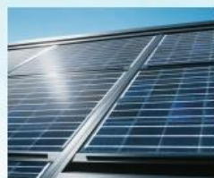
停電にそなえる 太陽光発電システム&蓄電池
